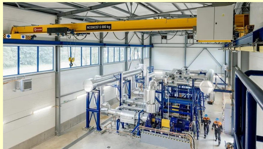
Čerpací stanice Obora v půlce trasy
